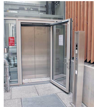
Der Fahrstuhl im Kulturquartier ist nur per Rufanlage zu benutzen.
